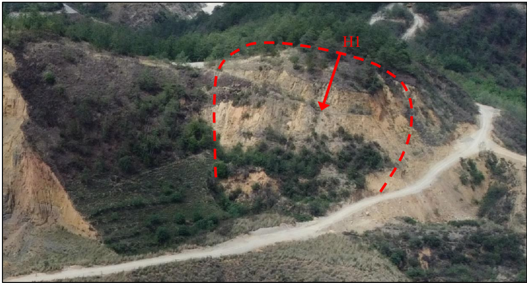
图 2.2-3 H 1 滑坡全景
