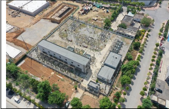
110kV 云龙坝变电站现状
